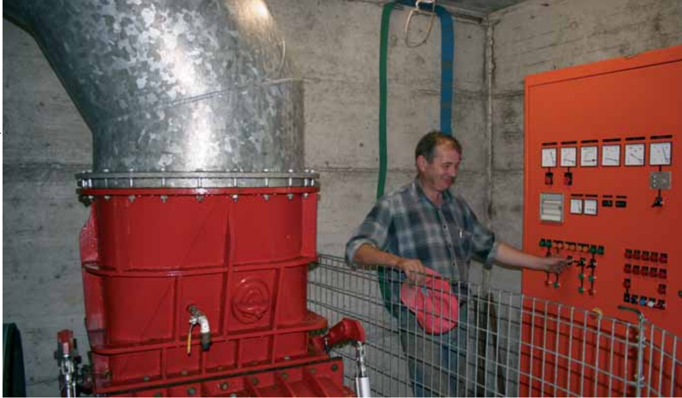
Bernhard Wipfli dans la chambre de la turbine et devant l'étang d'accumulation (photo du bas).
