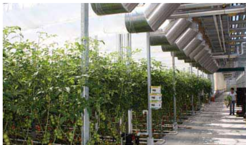
Les tubes dans lesquels circule l'air de la climatisation peuvent être remontés quand les employés récoltent des fruits ou soignent les plantes.
