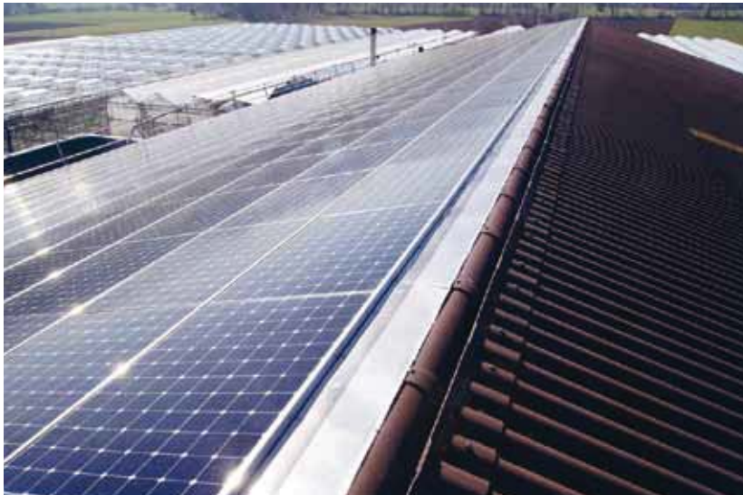
Cette installation réalisée sur le domaine Bioland de Stephan Müller, Steinmaur ZH, atteint une puissance de crête de 174,72 kWc et couvre une surface de référence de 893 m 2 .
