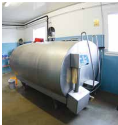
Les pompes à chaleur sont rentables pour les gros tanks de refroidissement.
