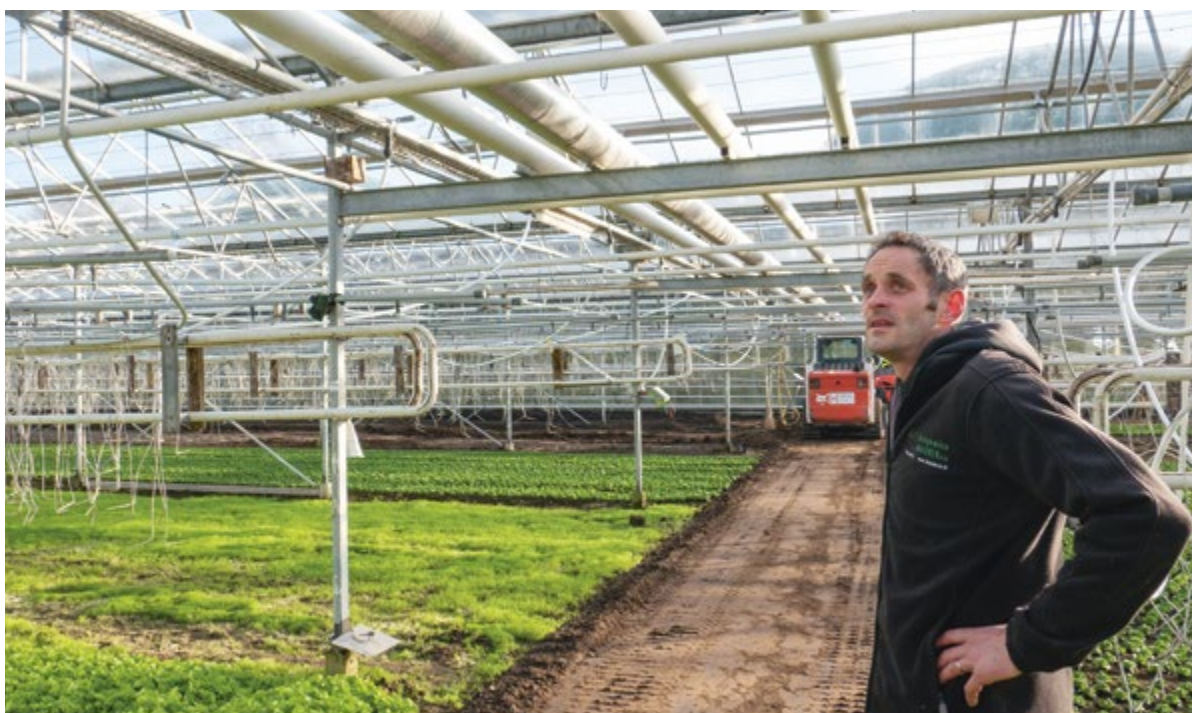
Le maraîcher bio David Maurer sous le système de tuyaux de chauffage de sa serre. L'eau du dispositif est chauffée par le cogénérateur d'une installation de biogaz voisine. Photo: David Eppenberger
