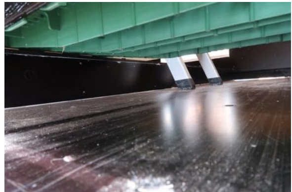
Abbildung 5: Entmistungskanal unter den Rostflächen (Bild: Tanja Kutzer)
